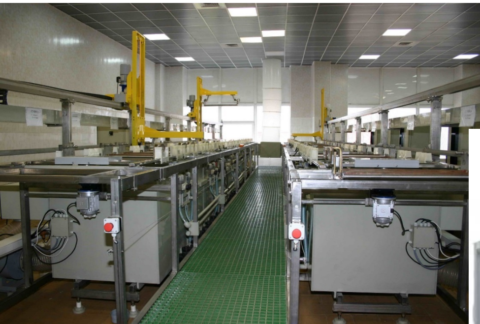
Гальваническая линия травления и твердого анодирования ТЕСАР- Экогаль
