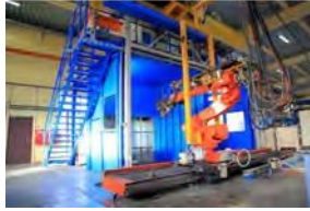
Dosier- Aufspritz- Hochdruckmaschine "Hennecke" - 1 St.
