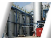
L'installation de la production d'hydrogène
