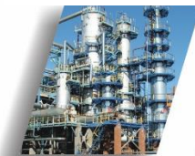
L'installation du traitement du condensat de gaz
