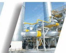
L'installation de la production d'hydrogène
