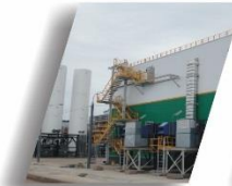
L'installation de la séparation d'air
