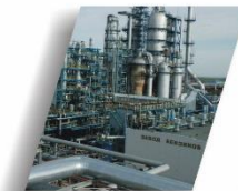
L'installation du craquage catalytique
