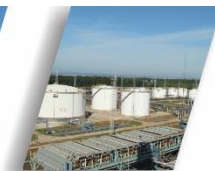
L'installation du compoundage de l'essence
