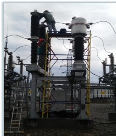
155 «Большекаменская» подстанциясен төзү "Татнефть" ГАҖ
