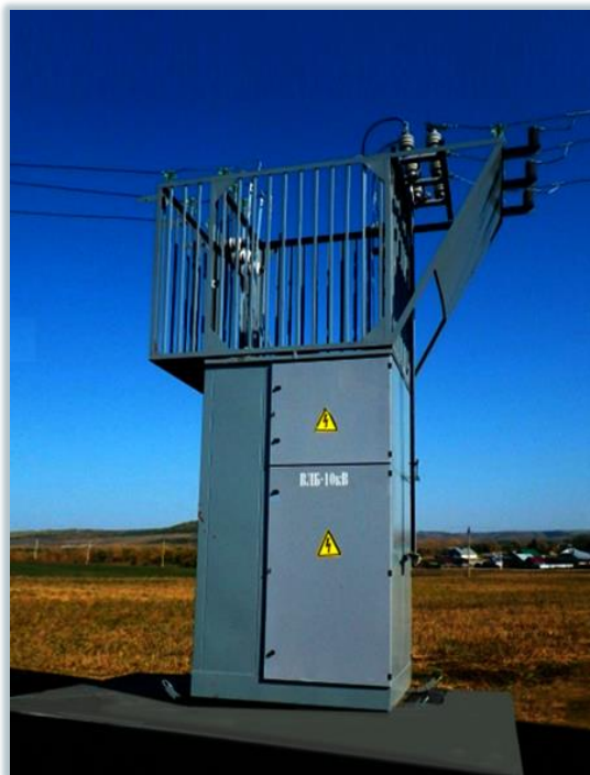
6 (10) кВ югары вольтлы линияле блок (ВЛБ)
