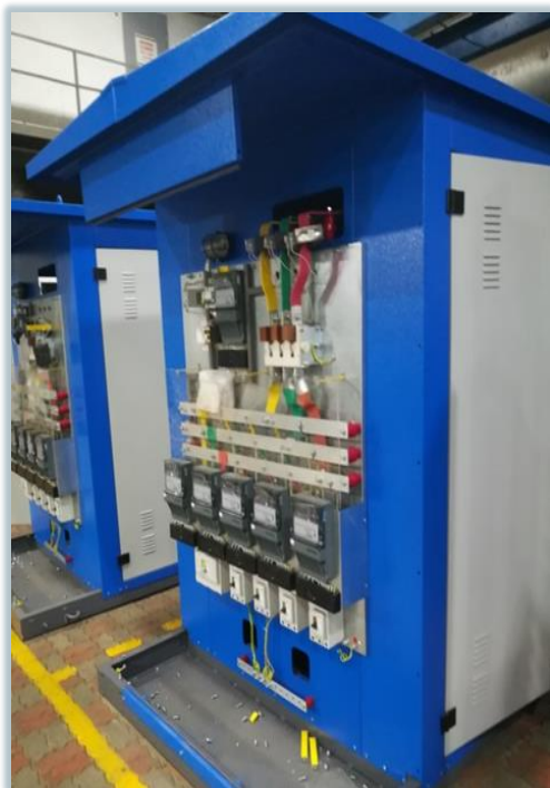
6 (10) кВ комплектлы трансформатор подстанциясе
