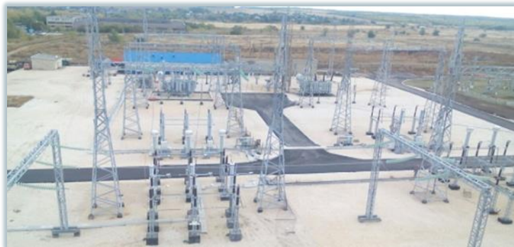
変電所 220 kV「復活」は、JSC「FGC UES」 MEAS ヴォルガ、サラトフ州支店の再建。
