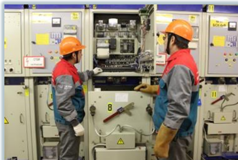
変電所 110/35/6 (10) のインストールと保守をリレー保護デバイスのマイクロプロセッサを含む kV
