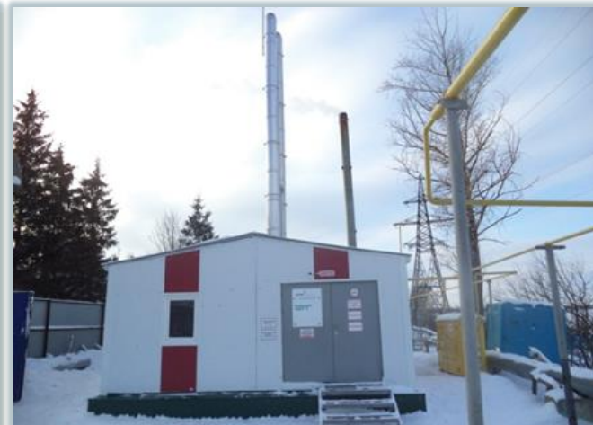
ボイラー室 155台。
