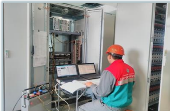
インストールおよび RZA、220 kV の変電所 「あすか」分野のニーズに「復活」の調整 JSC 「FGC UES」-ヴォルガ、 ハバンスク市
