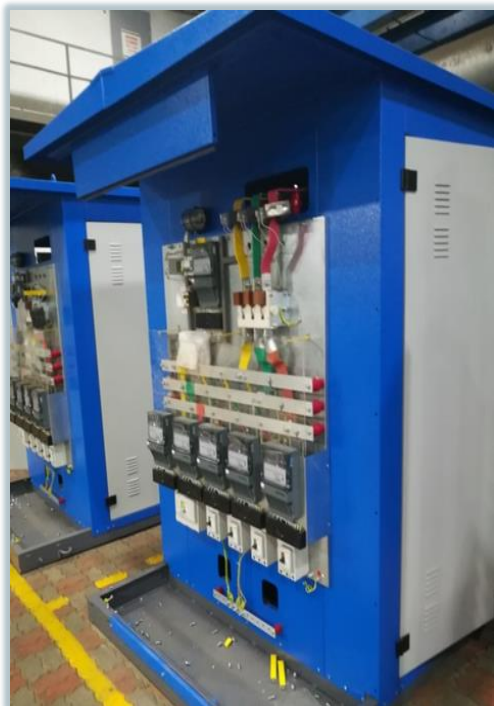
完全なトランス変電所 6 (10) kV
