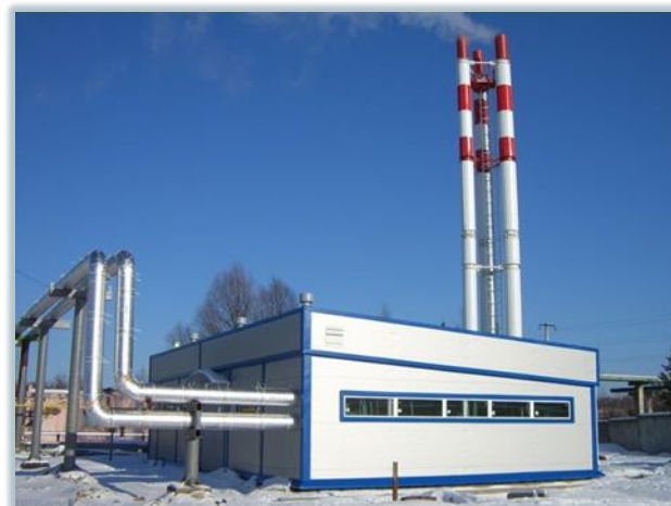
18 ボイラーユニット
