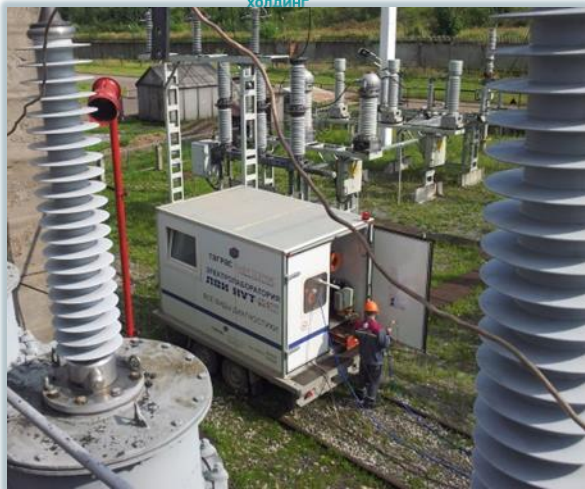
インストールおよび RZA、AMR 110/10/6 kV 変電所 「スヴェルドロフスク」の調整の中央電気ネットワーク 「Nizhnovjenergo」 ニジニ・ノヴゴロド
