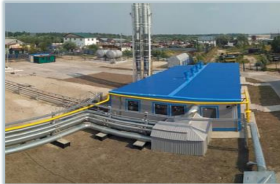
施設の設計 JSC 「Jamalkommunjenergo」: 「ボイラーの性能を 12.0Mw タルコサレ、プロヴスキー地区の町
