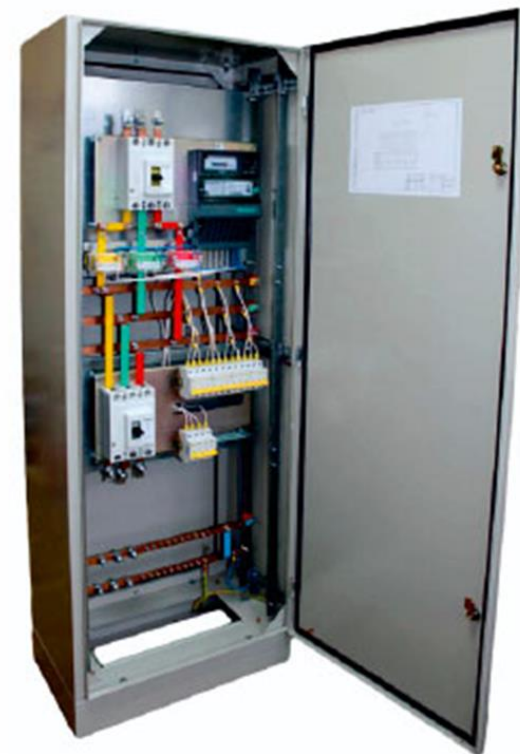
誘導開閉装置
