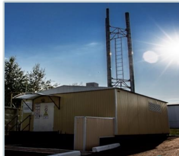
ボイラー (BMK)
