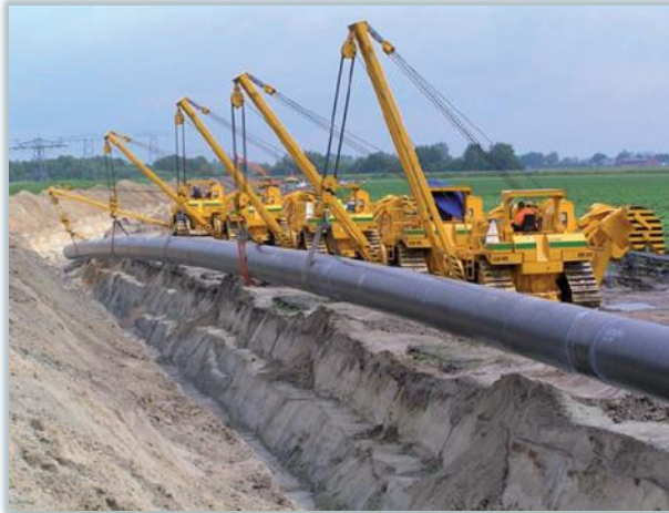
Plus de 8 000 km des tuyauteries
