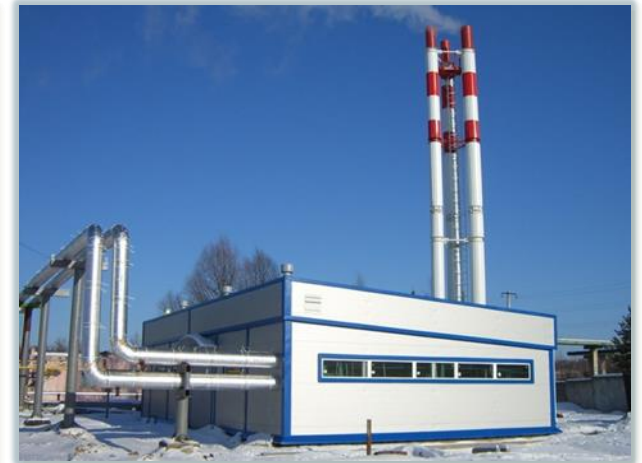
18 bâtiments des chaudières
