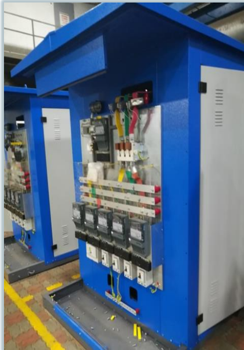
Les sous-stations complètes de transformation de 6 (10) kW
