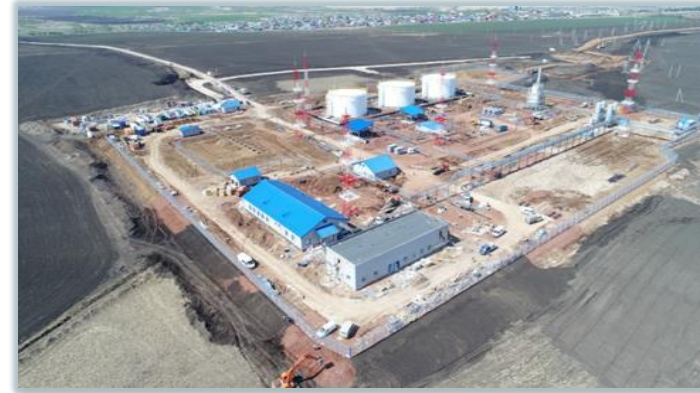
La construction de la station de la mise en service des tuyauteries pétrolières "Chechma-Kakeyino"
