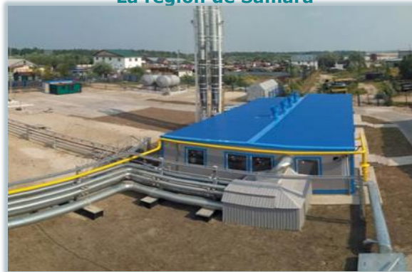
La conception de l'objet "AO Iamalkommunenergo" "La chaudière de la capacité de 12,0 MWt dans la ville Tarko-Sale de l'arrondissement Pourovskiy
