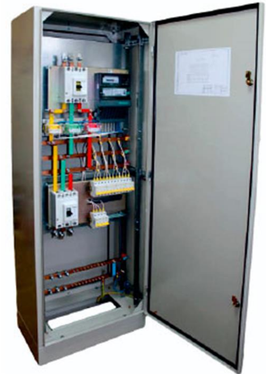
Le poste de livraison
