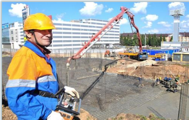
La construction du stationnement souterrain à plusieurs étages du Centre de commerce et de loisir
