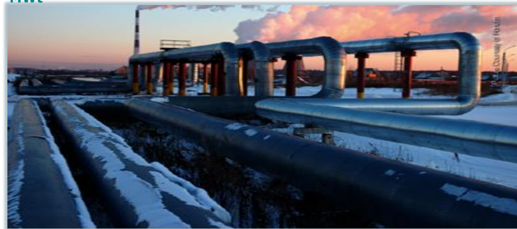
La maintenance des réseaux thermiques – 220 km
