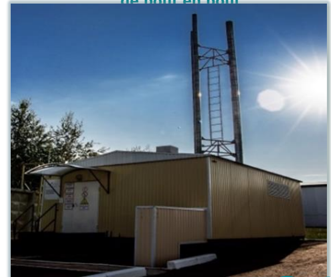
Les chaudières (de la compagnie BMK)
