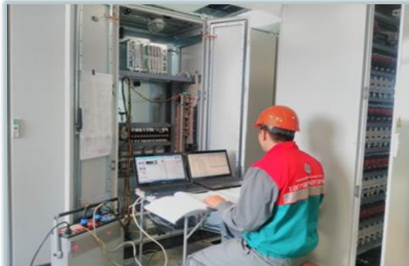
Le montage et le réglage de la protection par relais, le système automatisé du comptage commercial de l'énergie électrique de 220 kW, "Vozrojdeniye" pour les besoins de la filiale "OAO la Société Fédérale du Réseau National Unifiée Électrique - MES de la Volga"/"OAO FSK EES" la ville Khvalynsk
