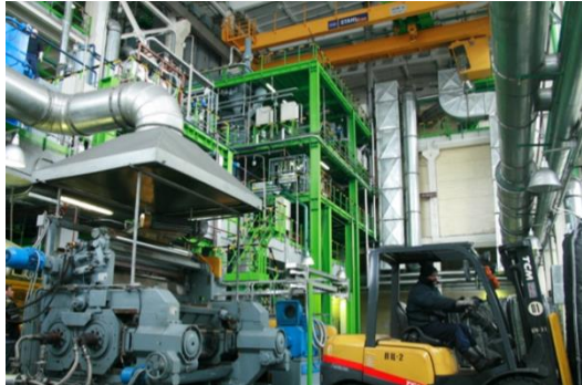
2007年 新しいゴム混合プラントの試 運転
